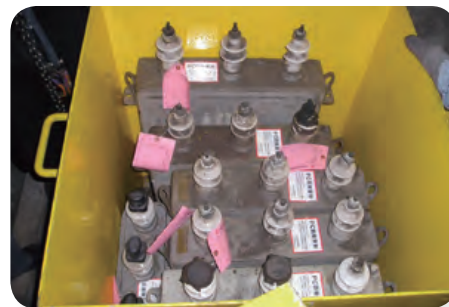
PCB含有トランス、コンデンサーの保管状況(知多工場)
