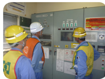
環境重点設備点検(星崎工場)
