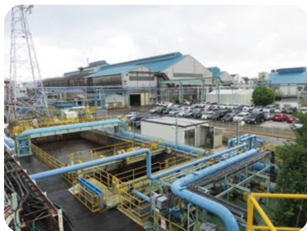
星崎工場排水処理
