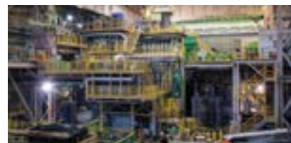
(注)生産能力強化の一環として 2016年に渋川工場に設置したVIMの写真です。
